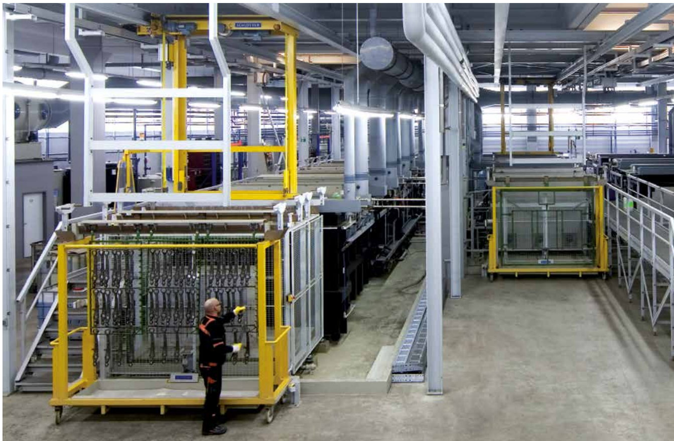
Anlage zur Beschichtung von Bauteilen für die Wasserelektrolyse
